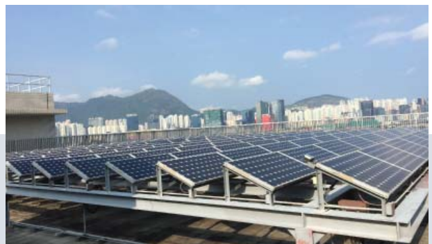
紅磡建業中心的太陽能板發電系統（既有建築上的加建改裝）
